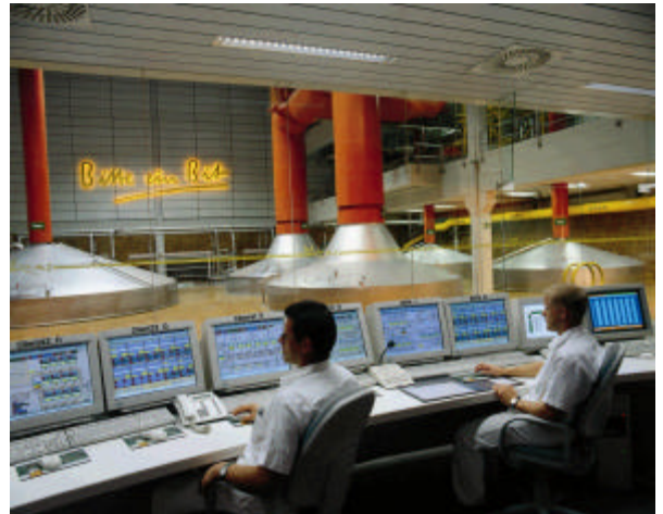
Schaltwarte im Sudhaus der Bitburger Brauerei
